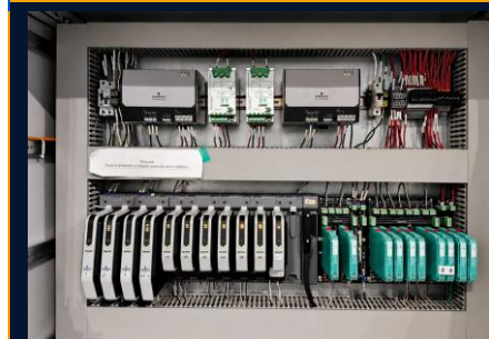
Control y distribución
