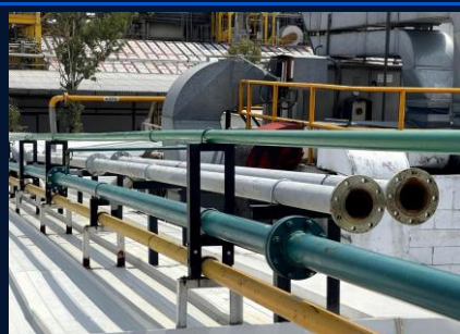
Tuberías de proceso
