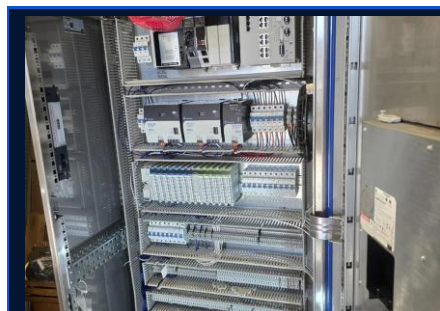
Automatización y tableros
